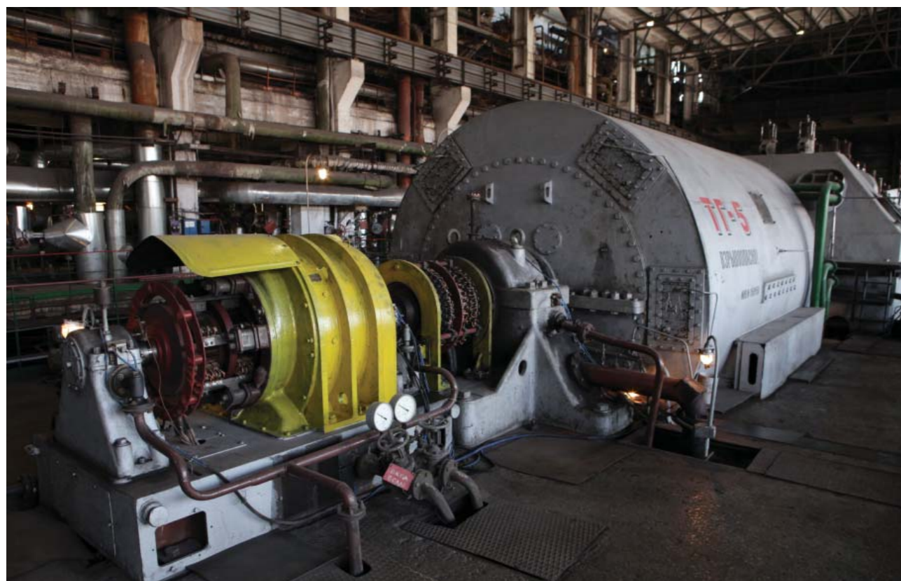
Самый мощный генератор ПАО «Тулачермет» — турбогенератор № 5
