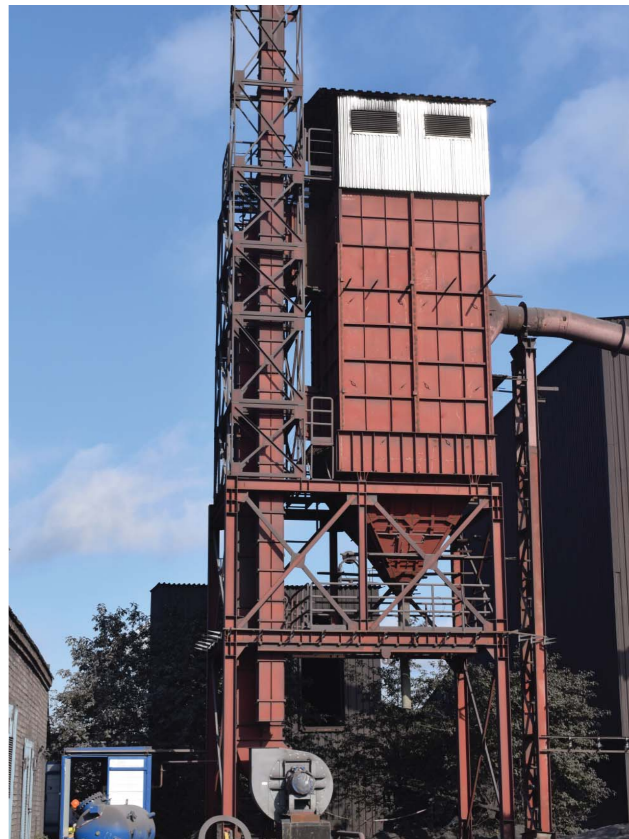
Аспирационные установки роторного вагонопрокидывателя и перегрузочного узла № 1 в доменном цехе
