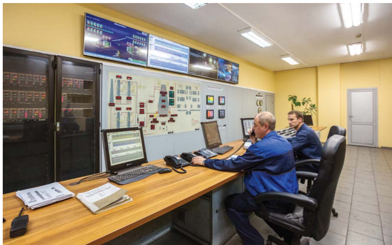
Пульт доменной печи № 3
