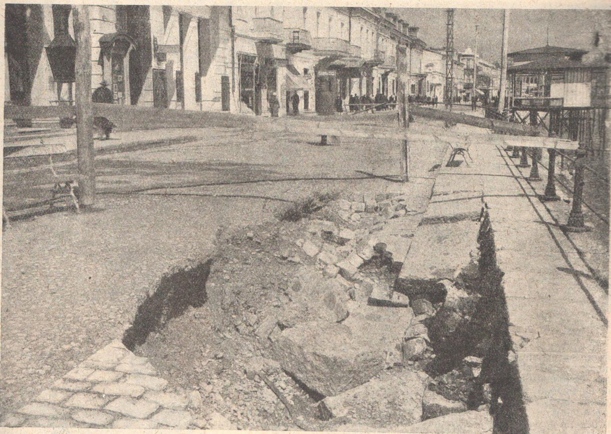
Обвал набережной в Ялте.
